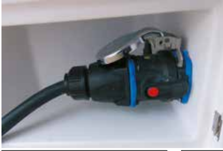
Allaccio elettrico da banchina
