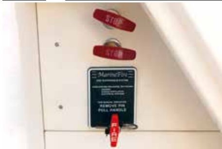
Tiranti intercettazione carburante
