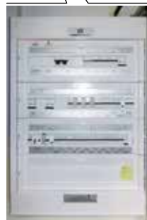
Quadro elettrico sala macchine
