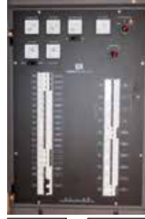
Quadro elettrico ponte di coperta
